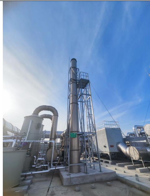
酸液喷淋吸收塔+DA001 排气筒
